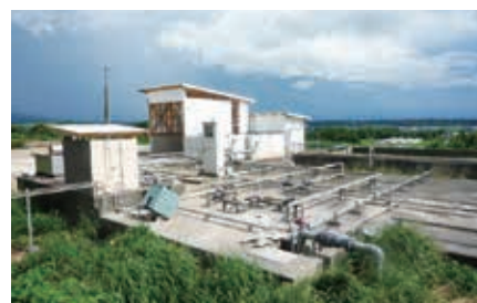
■ 熊本 豚舎污水排水処理施設
