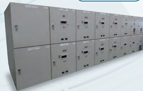
高圧受配電盤 H/V SWITCHGEAR
