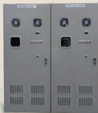
インバータ盤 INVERTER PANEL
