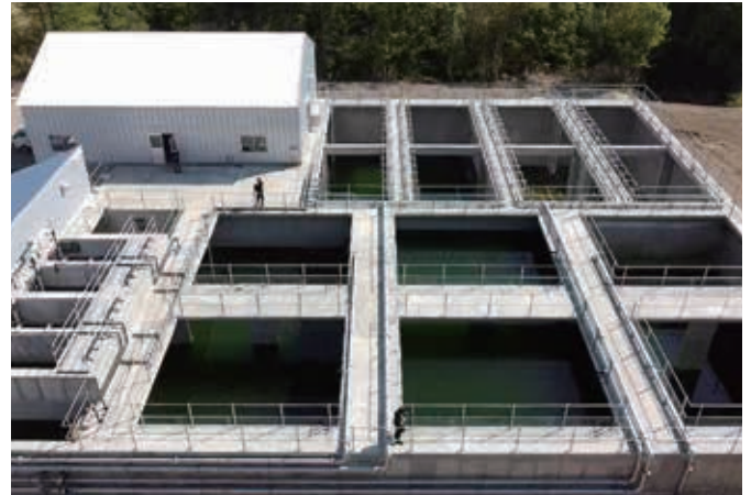
■ 秋田県 母豚1600頭一貫污水处理施設
