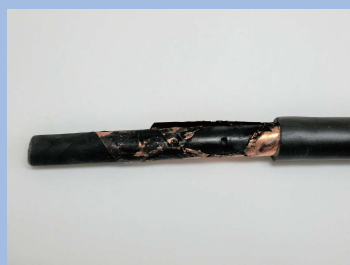
ケーブル事故写真
