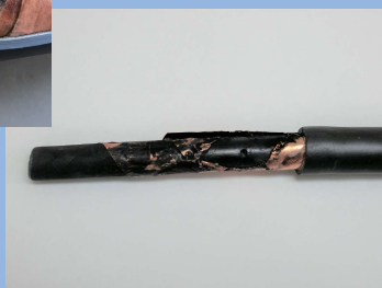
ケーブル事故写真
