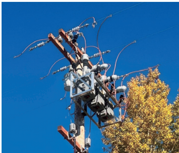
設置されたリクローザ (FAULT CLEAR®)
