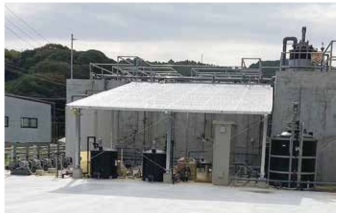
■ 880頭 スラリー汚水処理施設
