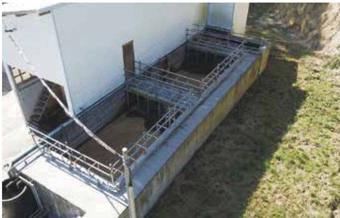
■ 300頭 スラリー汚水処理施設
