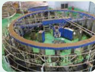
パーラー排水
