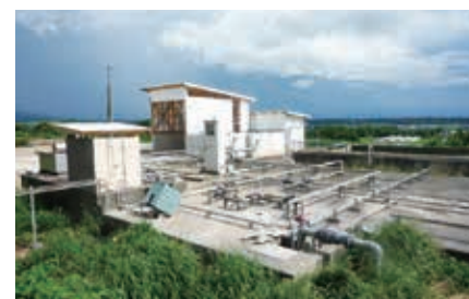
■ 熊本 豚舎污水排水処理施設
