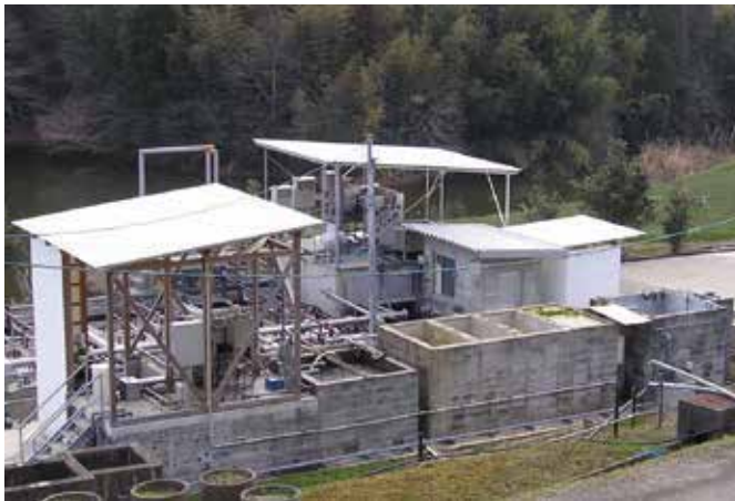
■ 佐賀県畜産試験場 家畜ふん尿総合的高度処理システム
