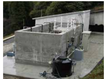
■ 佐賀県 母豚100頭一貫 污水处理施設
