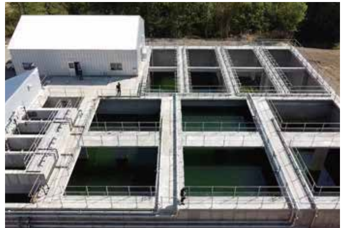
■ 秋田県 母豚1600頭一貫污水处理施設
