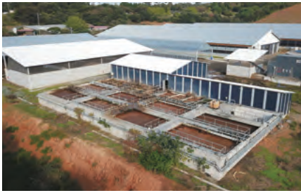
■ 鳥取 メタン発酵消化液汚水処理施設
