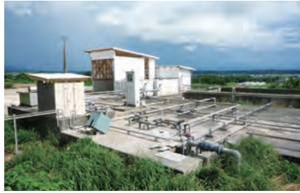
■ 熊本 豚舎汚水排水処理施設
